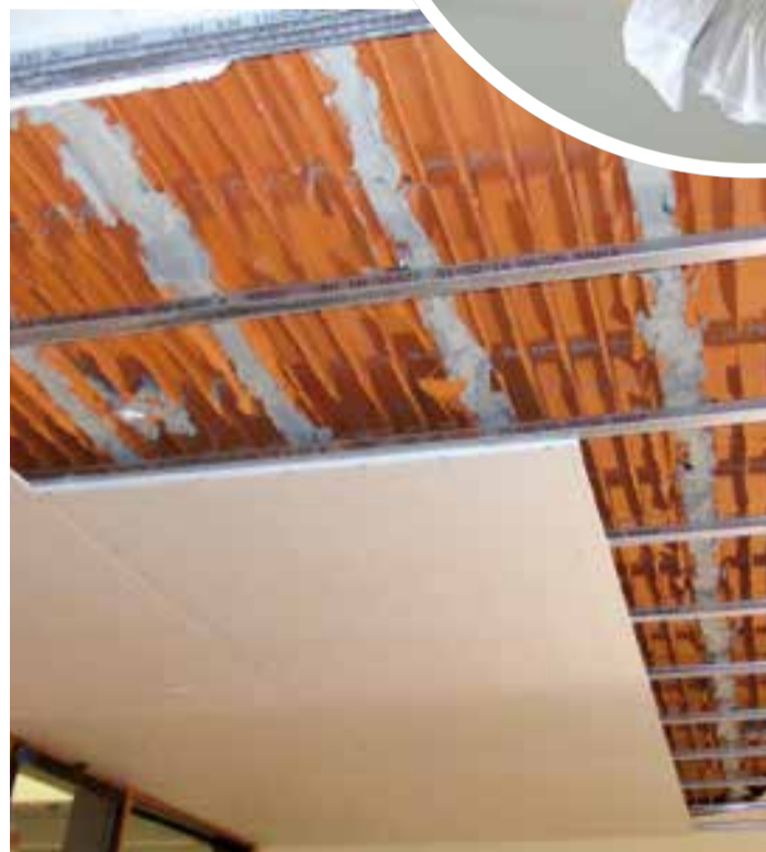
Fase di realizzazione del controsoffitto di protezione allo sfondellamento del solaio esistente
